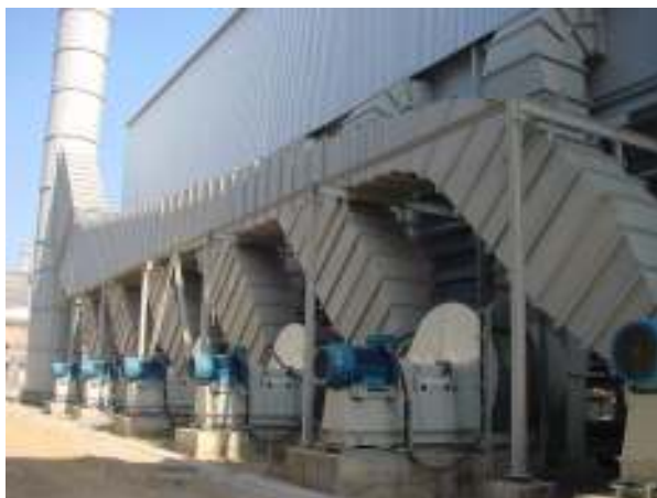
Čistilna naprava za suho čiščenje plinov
